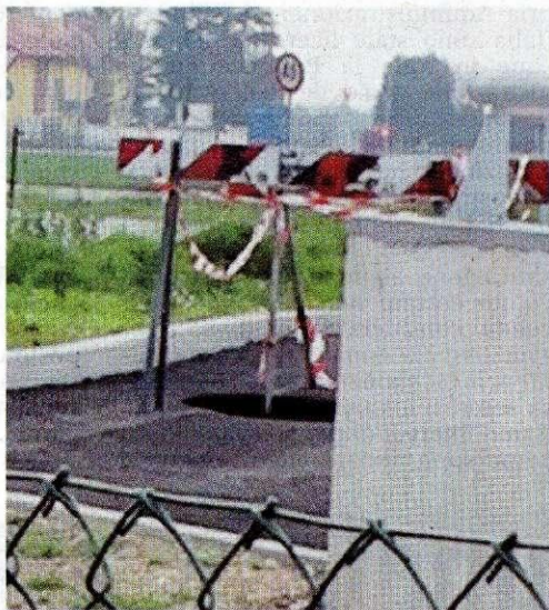
NUOVA ISOLA ECOLOGICA Altro che inaugurazione: a lavori ultimati si apre una grossa falla: il terreno ha ceduto
